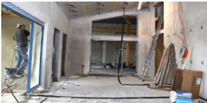
Noch ist das Foyer eine Baustelle. Die Durchflugschneise für die Wildgänsemodelle über dem Durchgang für die Besucher zur Ausstellungshalle ist schon klar erkennbar.
