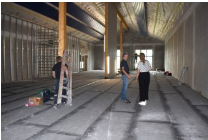
Die neue Ausstellungshalle steht, nun folgt sukzessive der Innenausbau und anschließend die Gestaltung der Ausstellungsräume.
